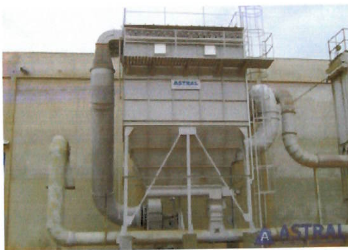
Figura 8– Filtro de Mangas tipo pulse-jet, com limpeza automática das mangas através de jatos de ar comprimido, comandadas por um seqüenciador eletrônico. (Fonte – Astral Controle Ambiental)
